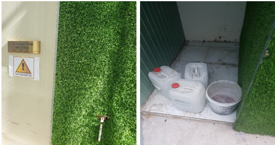
Hình 3. 6. Kho chứa chất thải nguy hại tại dự án
