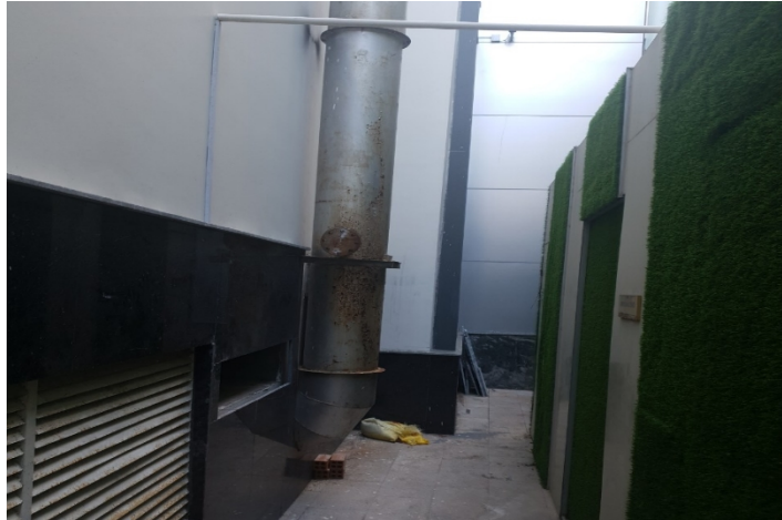
Hình 3. 5. Vị trí ống khói máy phát điện
