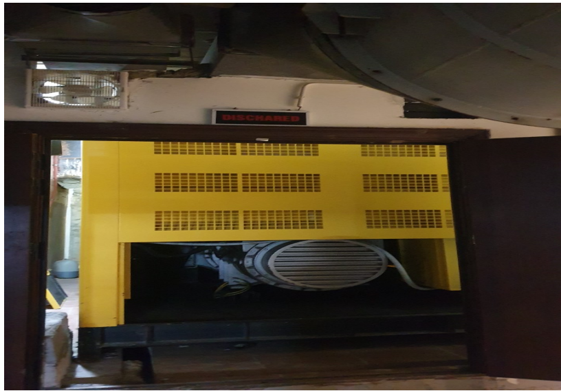
Hình 3.7. Máy phát điện đặt tại khu vực dự án
